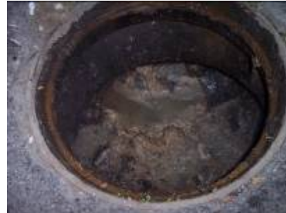
Las grasa tapan las tuberías sanitarias
